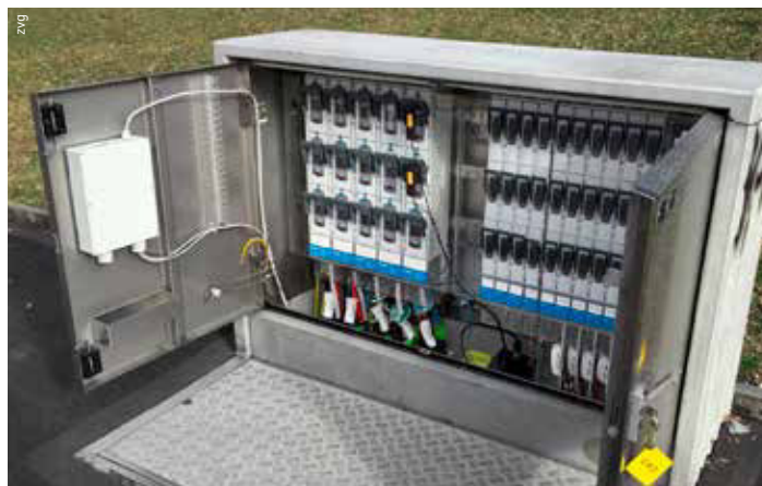
Beispiel einer Installation in einer Verteilkabine.
