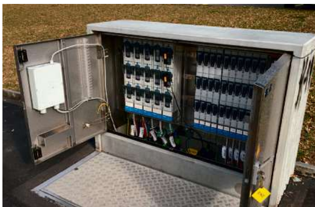
Bild 3 Beispiel einer Installation in einer Verteilkabine.
