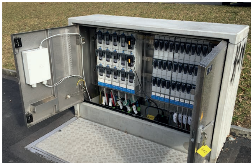
Bild 3. Beispiel einer Installation in einem Verteilerschrank
